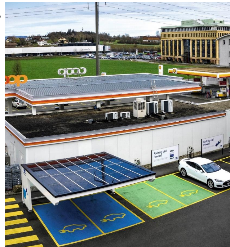
Schnellladestation mit PV-Anlage in Rotkreuz
